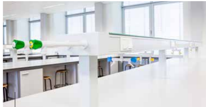
Foto 5: Tapkranen moeten gangbaar worden gehouden.
