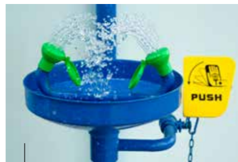
Foto 4: Oog- en gelaatsdouches worden uitsluitend doorstroomd aangesloten.
